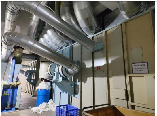
车间滤尘机组
