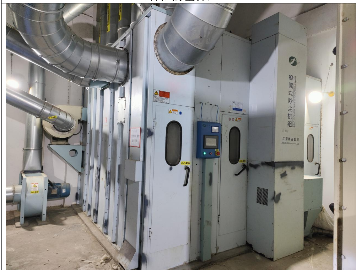
蜂窝式除尘机组（二车间合计 11 台）
